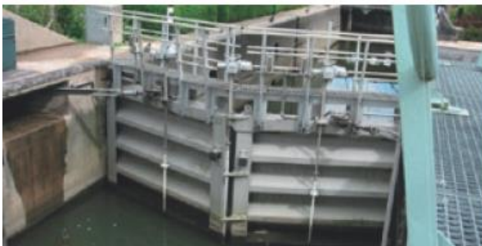
1.7 pav. FRP užtvankos šliuzo vartai, įrengti Verkendame, Olandijoje (Ascione et al. 2016:16)
