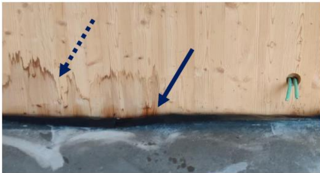
12 pav. Išorinės pastato CTL plokštės pažeidimai atsiradę jungtyje tarp sienos ir pamato (Kalbe, Kukk ir Kalamees, 2020, p. 3)
