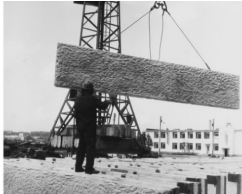
2.32 pav. Sieninės plokštės pagamintos Kauno II gelžbetoninių konstrukcijų gamykloje, O. Michailo nuotr., 1976, LCVA Fig. 2.32. Wall panels made in Kaunas II reinforced concrete structures factory, photo by O. Michail, 1976, LCVA
