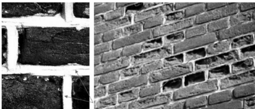
2.4 pav. Druskų kristalizacijos pažeistos mūro siūlės ir ištrupėjusios plytos
