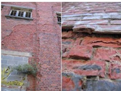
2.2 pav. Šalčio paveiktas mūras
