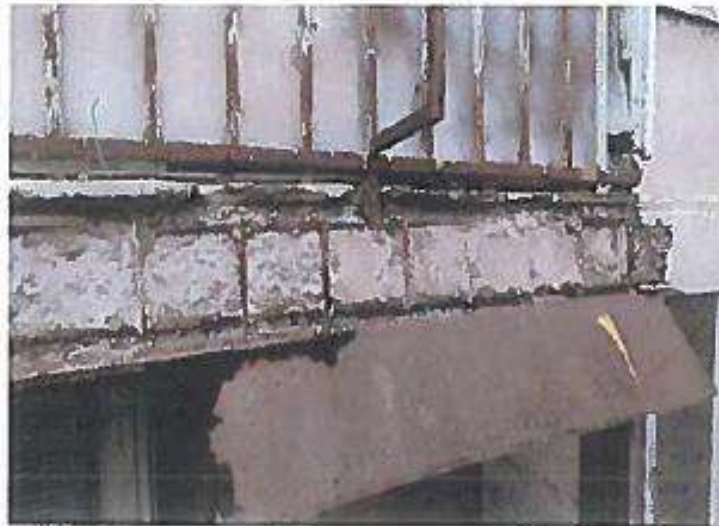
2.18 pav. Balkono Nr. 46 išilginės briaunos vaizdas su suirusiu armatūros apsauginiu sluoksniu (Elenbergas 2014)
