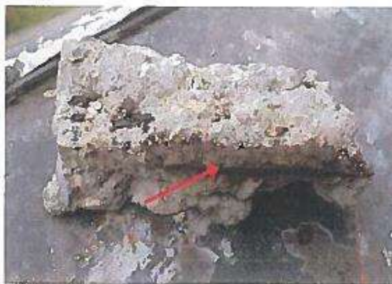
2.21 pav. Iš balkono Nr. 47 perdangos plokštės išimta suirusios briaunos dalis, kartu su armatūros likučiu (raudona rodyklė žymi surūdijusį armatūros likutį) (Elenbergas 2014)
