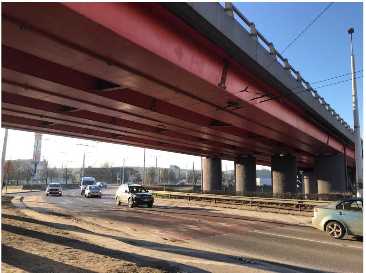
3.4 pav. Nekarpytos metalinės estakados sijos, kurios gali būti paveiktos automobilinės cisternos gaisro (autorės nuotrauka)
