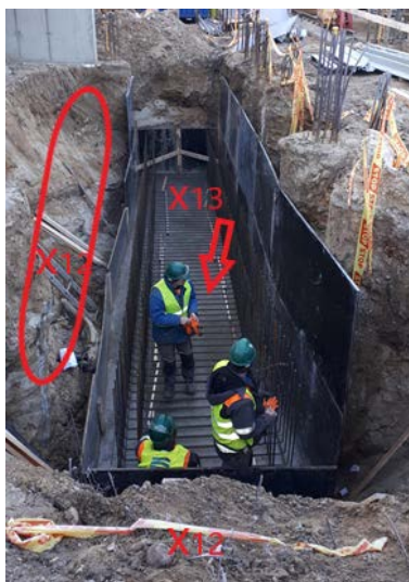
19 pav. Pavojus betonuotojui dėl daiktų kritimo iš viršaus, pavojus dėl suklupimo ir žemių užvirtimo
