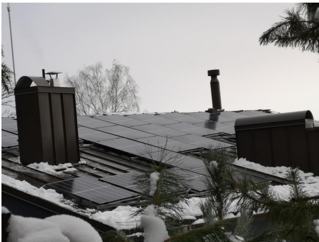
2.2.1.1. pav. Tiriamoji saulės elektrinė
