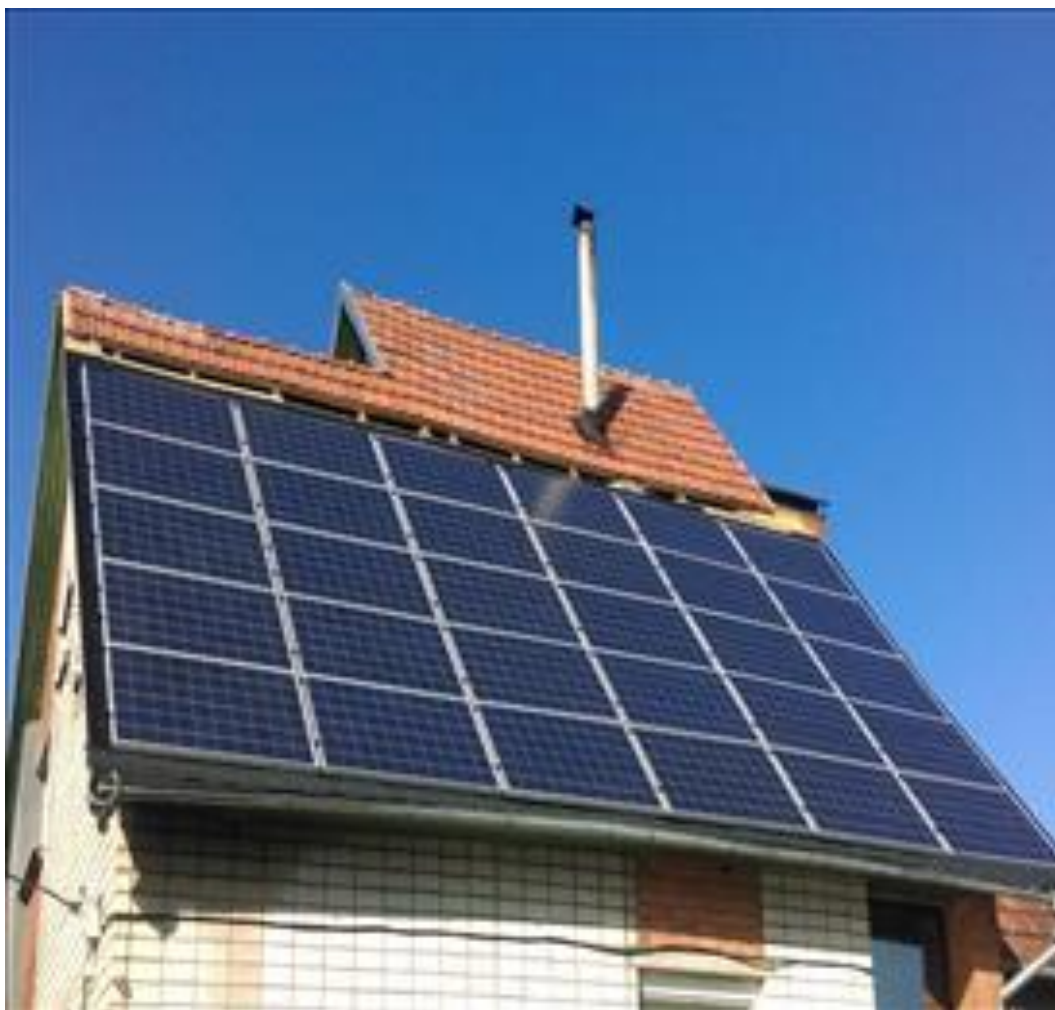
2.1.1.1. pav. Pirmoji tiramoji saulės elektrinė.
