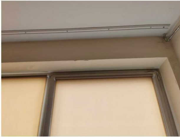
1 pav. Vandens paveikta patalpa.
