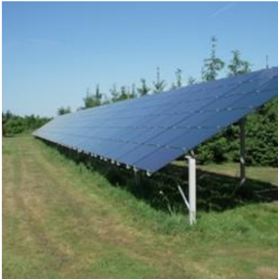
3.1 pav. 12 kW p Saulės elektrinė
