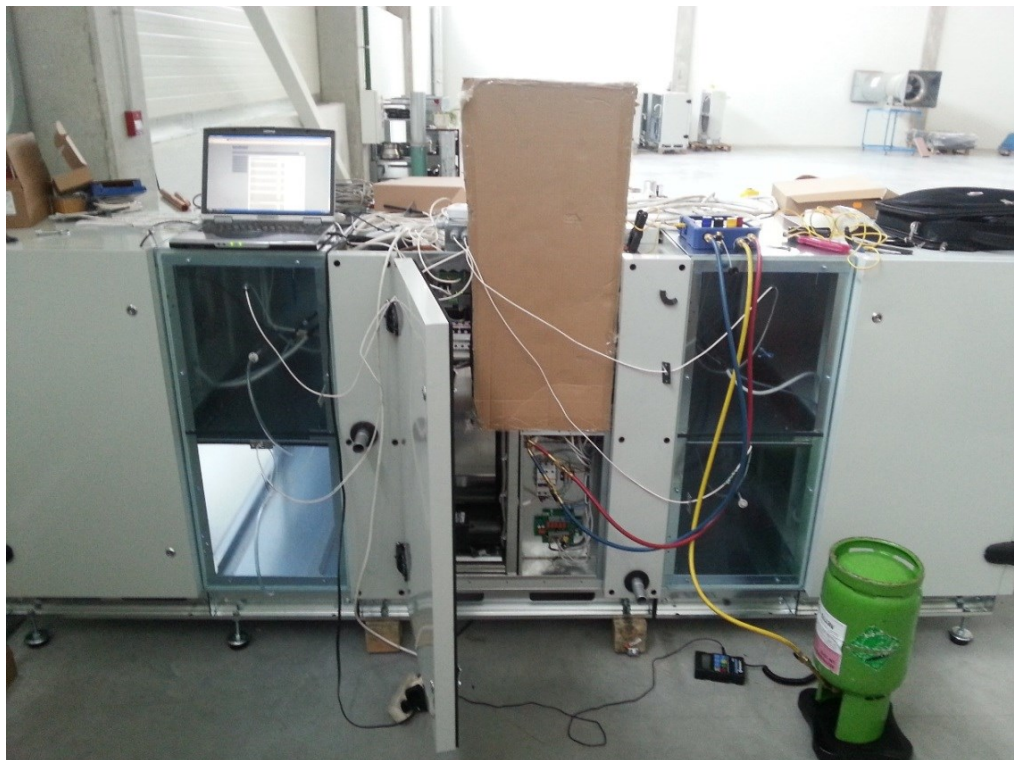
51 pav. „Komfovent Verso 10RHP“ įrenginys matavimo metu
