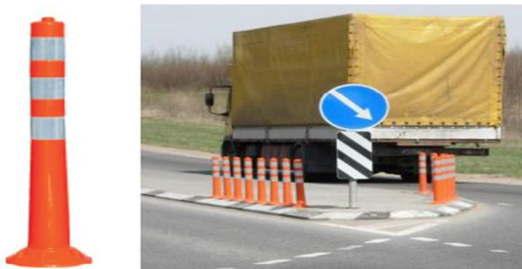
3.2 pav. Saugumo salelėje sumontuoti oranžinės spalvos signaliniai stulpeliai su šviesą atspindinčiais elementais
