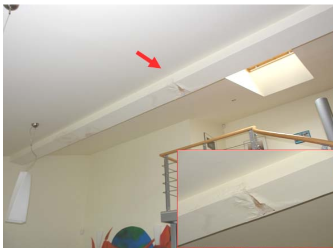
2.4 pav. Drėgmės pažeistos konstrukcijos Fig. 2.4. Constructions affected by damp
