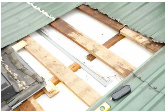
2.3 pav. Drėgmės pažeistos stogo konstrukcijos Fig. 2.3. Roof constructions affected by damp
