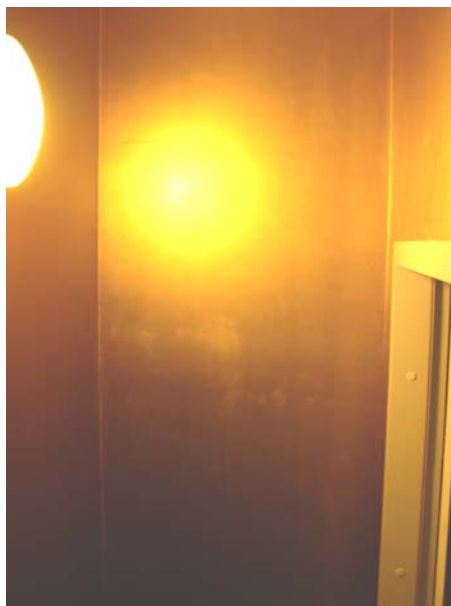
2.7 pav. Nekokybiškai nudažyti sienų paviršiai Fig. 2.7. Not qualitatively painted surfaces of the wall
