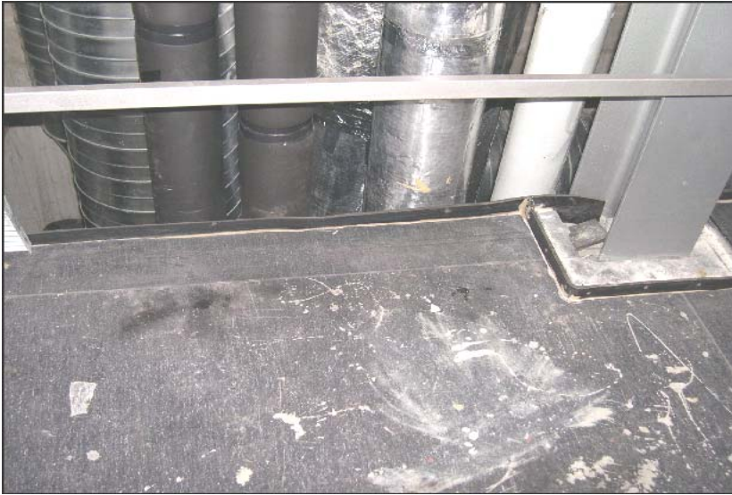
2.6 pav. Pažeistos grindų dangos fragmentas
