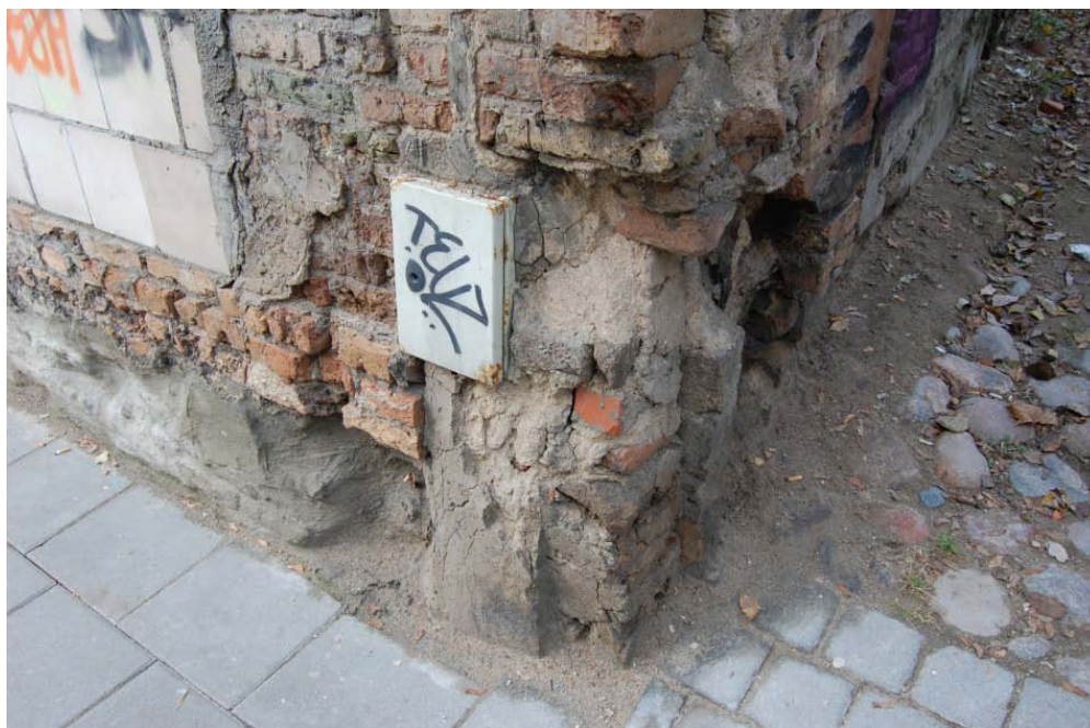
3.2.1.3 pav. A korpuso cokolio fotofiksacija
