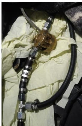
2 pav. AIC systems 1200 flow meter tiekiamų degalų linijos matavimo įrenginys
