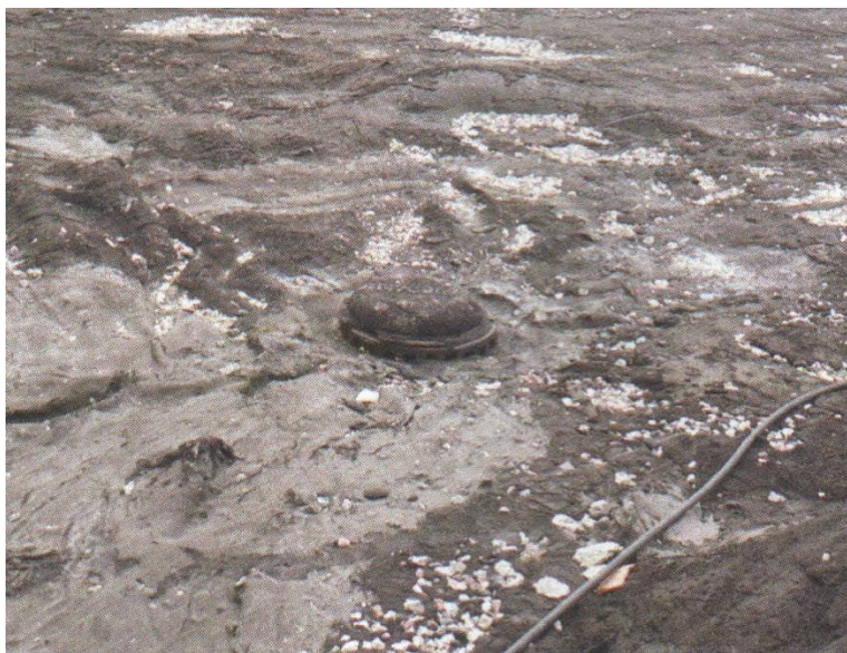
1.8 pav. Susidėvėjusi bituminė danga (Ignatavičius 2010)
