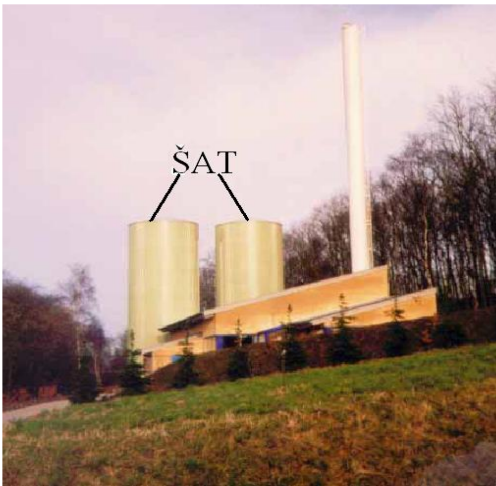
12 pav. Dviejų šilumos akumuliacijos talpų sistema, įrengta dujas deginančioje kogeneracinėje jėgainėje [9]
