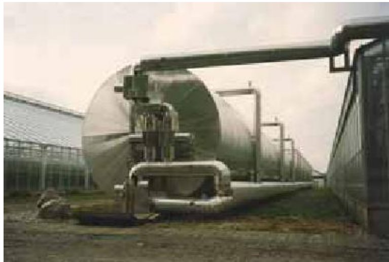
8 pav. Horizontali šilumos akumuliacijos talpa, įrengta šiltnaminių aptarnavimui skirtoje kogeneracinėje sistemoje [9].
