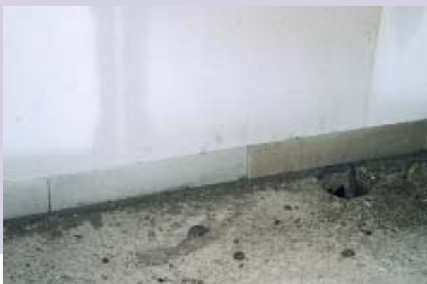
Fußpunktausbildung ohne Wärmebrückenmaßnahme, dadurch kann Feuchtigkeit ins Mauerwerk aufsteigen.
