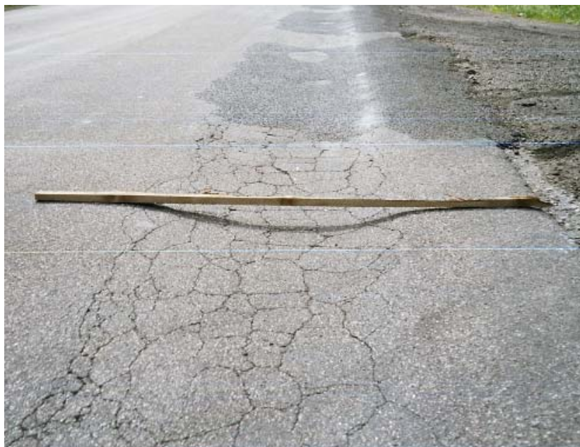
3.2 pav. Provėžų ir plyšių atsiradimas kelio dangos konstrukcijoje dėl blogo vandens drenažo (COST Action 351 – WATMOVE 2007)
