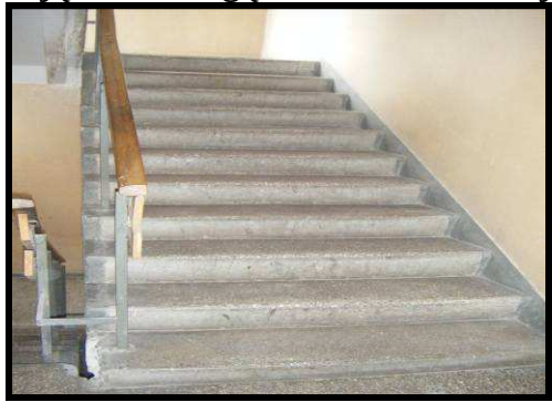
A.76 pav. Tiesūs laiptatakliai, išpėjamųjų paviršių nebuvimas
