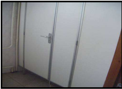
A.17 pav. Nepritaikyti sanitariniai mazgai
