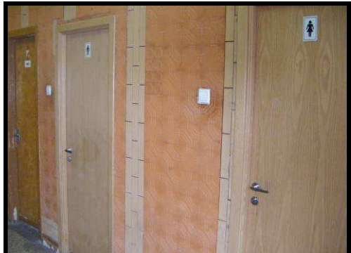
A.68 pav. Nepritaikyti sanitariniai mazgai
