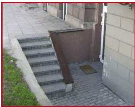
8 pav. Laipteliai į pusrūsį turi būti iš šonų aptverti apsaugine tvorele
