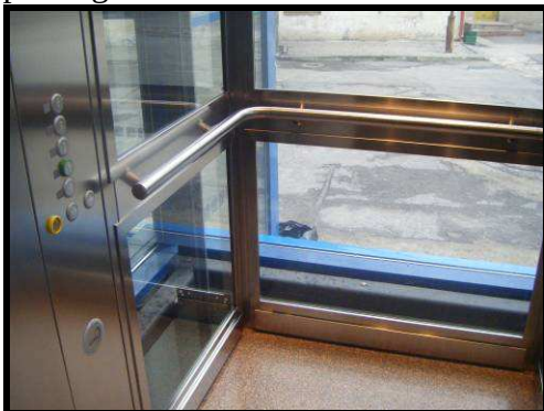
A.44 pav. Lifto kabina, turėklai lifto kabinoje, lifto valdymo mygtukai
