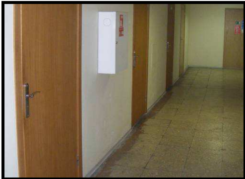
A.67 pav. Atsikišę elementai ir konstrukcijos koridoriuose ir kitose patalpose
