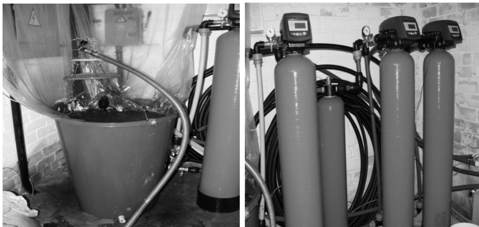
2.5 pav. Atvirasis aeratorius ir slėginiai filtrai
