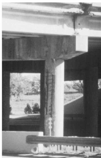
1.17 pav. Tiltų konstrukcijos, pažeistos druskų cheminio poveikio (Schokker et al., 1999)
