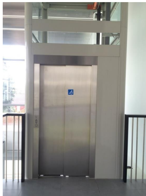
3.8 pav. Liftas, pritaikytas neįgaliesiems
