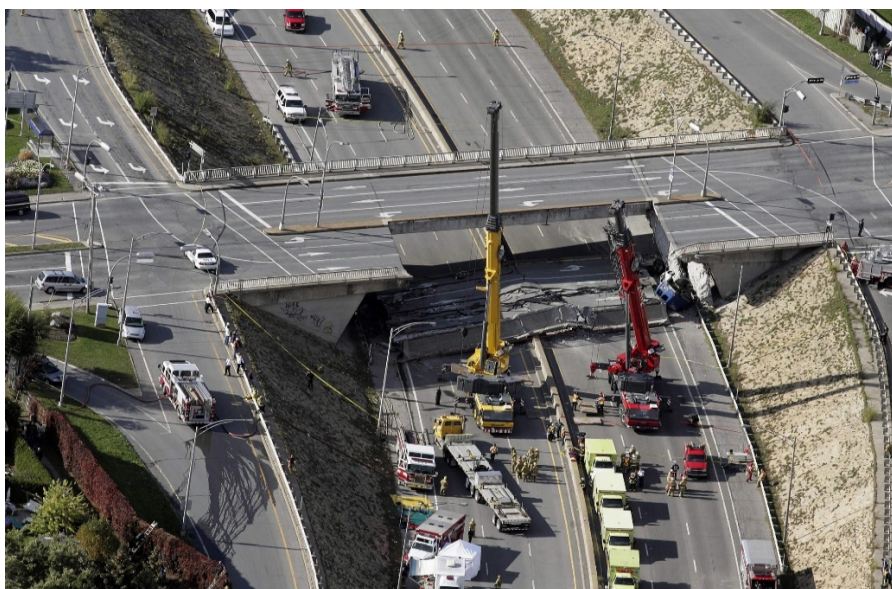
1.3 pav. De la Concorde tilto griūtis (Lau, 2016)
