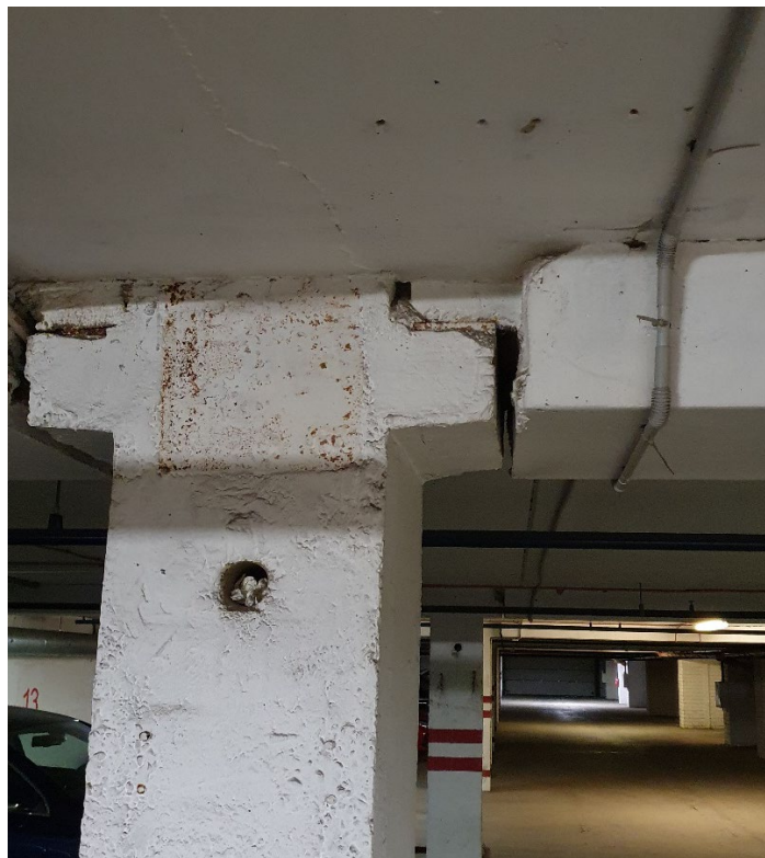
1.8 pav. Sija su įpjova požeminėje automobilių stovėjimo aikštelėje Vilniuje
