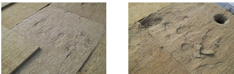
5.9 pav. Termoizoliacinė medžiaga po vaikščiojimo ant jos klojimo metu Fig. 5.9. Thermal insulation material after the impact of pedestrian traffic during installation
