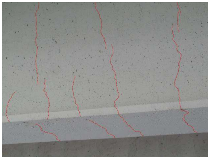
1.5pav. Plyšiai gelžbetoninėje perdangoje.
